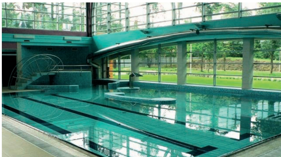
Kryta Pływalnia w Warszawie Wawrze (6 x DanX 16/32 + 2 x DanX 2/4 + szyny nawiewne)
